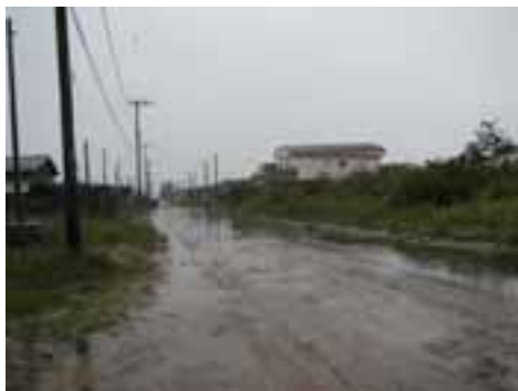
MON09PON16FOT02 - Sistema viário sem pavimentação e sem drenagem adequada
