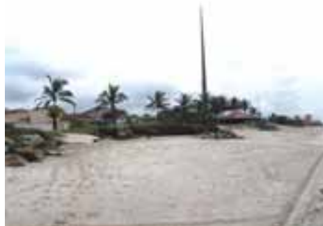
ITA10PON26FOT02 - Detalhe da erosão mostrando enrocamento de proteção em base de poste
