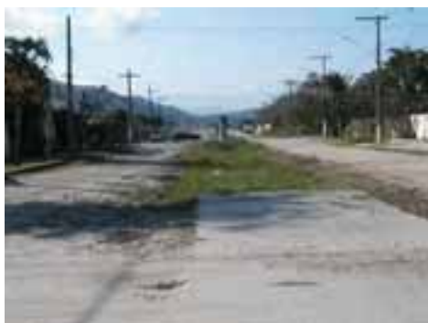
GUA54PON153FOT02 - Canal existente assoreado e obstruído
