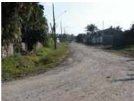
GUA55PON156FOT01 - Viário com microdrenagem inexistente
