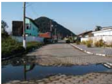
MON05PON11FOT01 - Microdrenagem com problemas de obstrução ou limpeza
