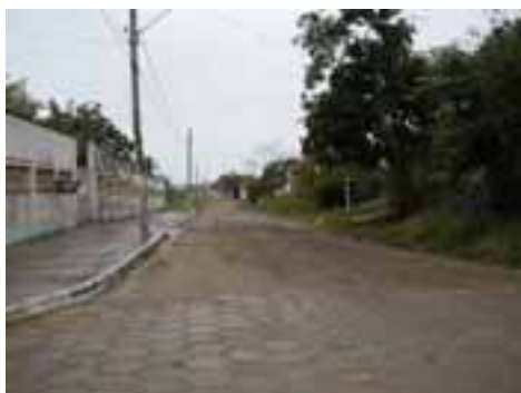
PER01PON02FOT01 - Microdrenagem inexistente
