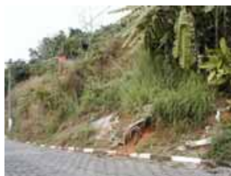
ITA11PON30FOT02 - Talude sobre calçada, colocando em risco a via
