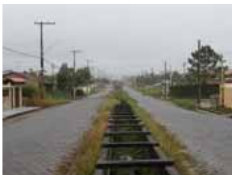
PER13PON34FOT01 - Canalização existente obstruída e assoreada
