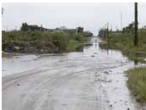
MON04PON10FOT01 - Sistema viário com pavimentação e sem drenagem adequada
