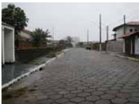
PER10PON28FOT01 - Microdrenagem obstruída e assoreada
