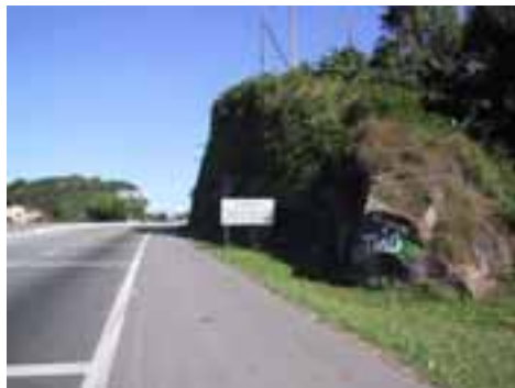
MON13PON26FOT01 - Talude em rocha / solo junto a pista da Rod. Padre Manoel da Nobrega (sentido Praia Grande - Itanhaém) colocando em risco a rodovia e postes de energia.
