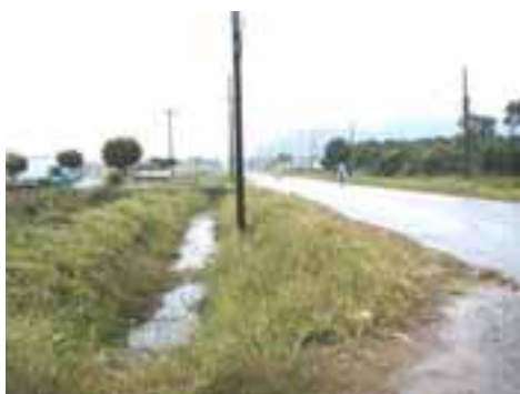
ITA07PON20FOT01 - Sistema de micro e macrodrenagem inexistente
