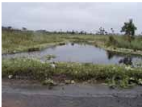
MON01PON01FOT02 - Calha natural do córrego existente assoreada
