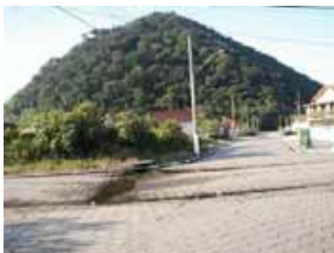
MON05PON12FOT01 - Microdrenagem com problemas de obstrução ou limpeza
