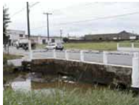
ITA03PON11FOT02 - Travessia afogada e assoreada na Rua 31 de Março
