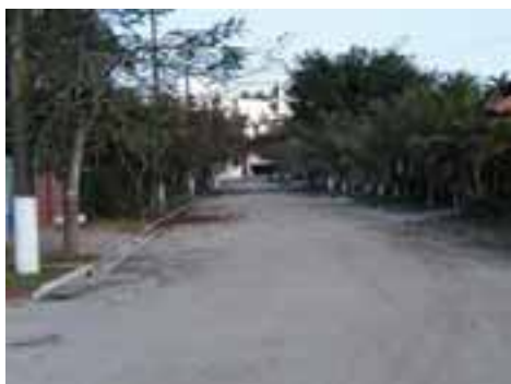
GUA56PON160FOT02 - Viário com microdrenagem assoreada e obstruída
