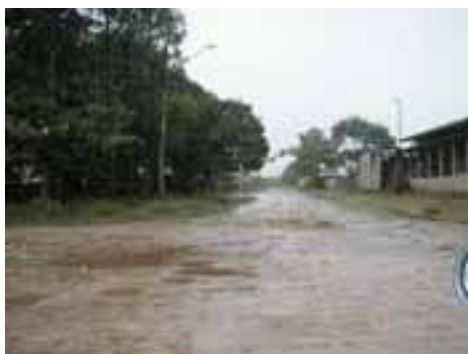
PER05PON16FOT03 - Microdrenagem insuficiente
