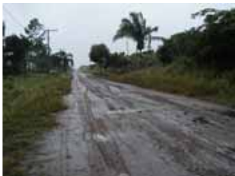
PER17PON41FOT01 - Microdrenagem inexistente
