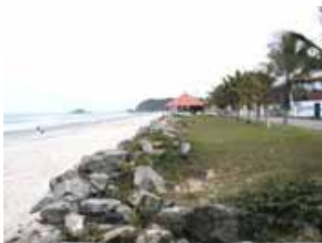
ITA10PON27FOT03 - Erosão ao longo da praia junto a Av. Pres. Vargas
