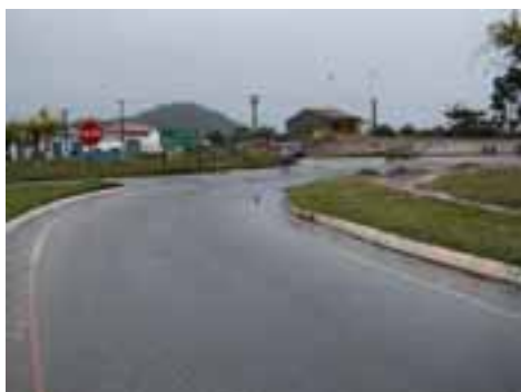
PER18PON42FOT01 - Microdrenagem obstruída e insuficiente
