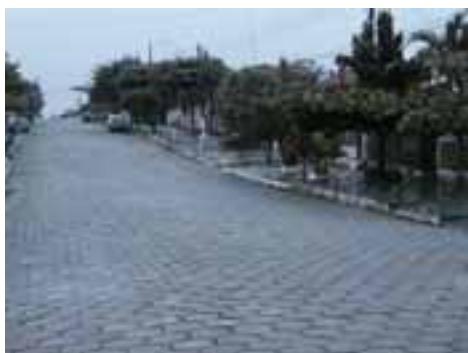
PER12PON32FOT02 - Microdrenagem com problemas de obstrução ou limpeza
