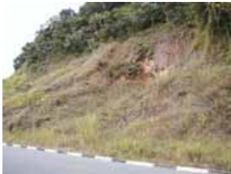
ITA08PON23FOT01 - Trecho da encosta do morro Praia do Sonho junto a Av. Wallace Artur Skerat, onde ocorreu o deslizamento em 1996
