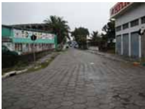
PER09PON25FOT02 - Microdrenagem obstruída e assoreada
