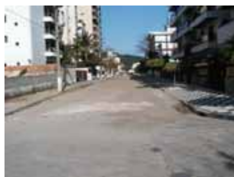
GUA54PON154FOT01 - Viário com microdrenagem inexistente
