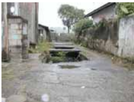
ITA04PON12FOT01 - Galeria existente danificada e obstruída
