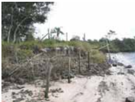
ITA09PON25FOT02 - Trecho de erosão margem direita do Rio Itanhaém vista jusante para montante
