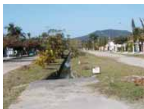
GUA54PON152FOT01 - Viário com microdrenagem inexistente
