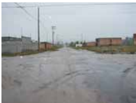
PER15PON37FOT01 - Microdrenagem inexistente
