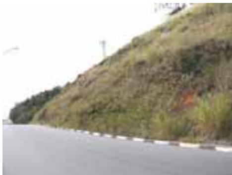
ITA08PON22FOT01 - Trecho da encosta do morro Praia do Sonho junto a Av. Wallace Artur Skerat, com blocos de rocha colocando em risco aquela avenida
