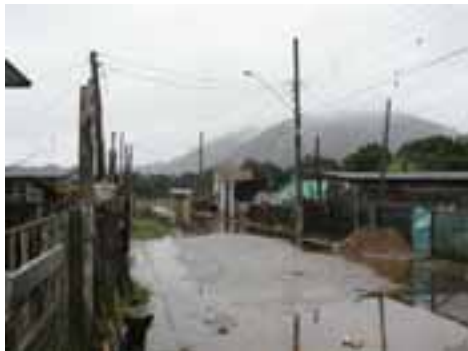
MON09PON17FOT01 - Sistema viário com pavimentação e sem drenagem adequada
