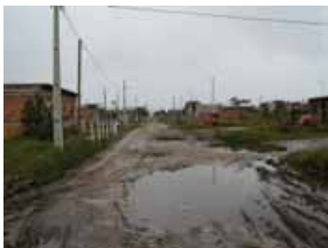
PER11PON30FOT01 - Microdrenagem inexistente
