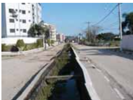
GUA54PON164FOT02 - Canal existente assoreado e obstruído
