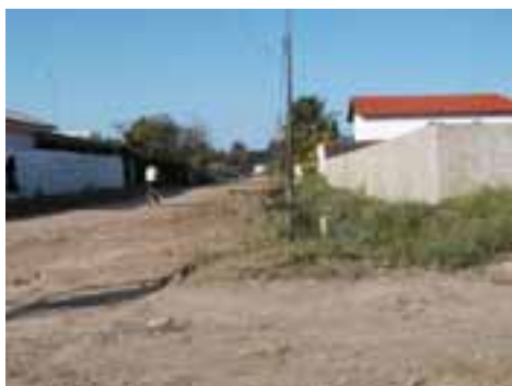
GUA55PON157FOT01 - Viário com microdrenagem inexistente
