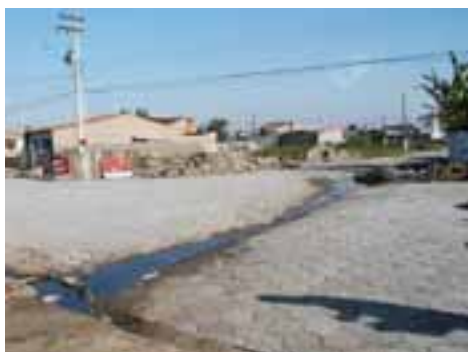
MON10PON20FOT01 - Sistema viário com pavimentação e sem drenagem adequada
