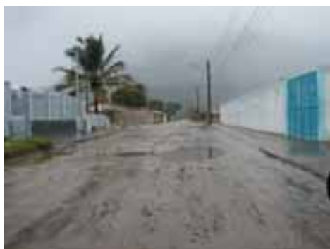
PER05PON16FOT02 - Microdrenagem insuficiente
