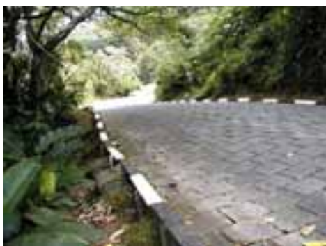
ITA11PON29FOT02 - Talude inferior junto à via em risco de deslizamento
