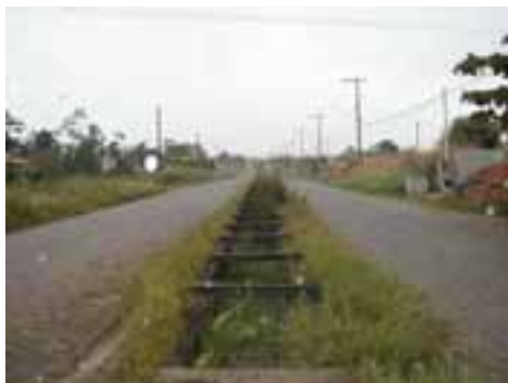
PER13PON33FOT01 - Canalização existente obstruída e assoreada
