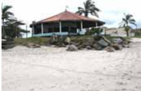
ITA10PON26FOT01 - Detalhe da erosão mostrando enrocamento de proteção em quiosque
