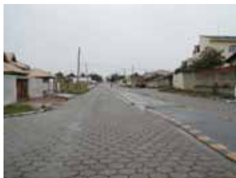
PER07PON21FOT02 - Microdrenagem obstruída e insuficiente
