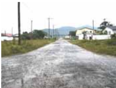
ITA07PON19FOT01 - Sistema de micro e macrodrenagem inexistente
