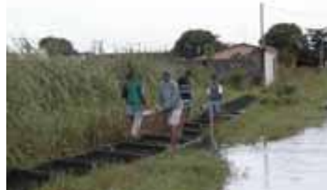
MON03PON08FOT01 - Canal de concreto danificado e assoreado
