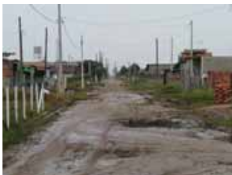
PER11PON30FOT02 - Microdrenagem inexistente
