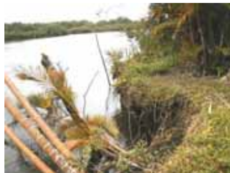
ITA09PON25FOT08 - Detalhe da erosão na margem direita do Rio Itanhaém
