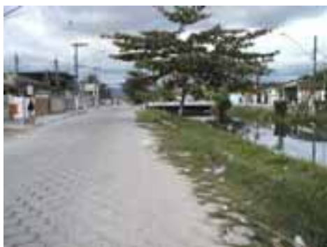
SVI49PON82FOT01 - Canal existente sem proteção e assoreado
