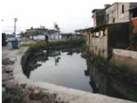
SVI69PON121FOT03 - Canal existente assoreado e obstruído
