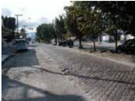
SVI27PON50FOT01 - Viário com microdrenagem assoreada e obstruída
