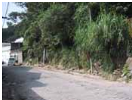
SVI81PON149FOT01 - Talude junto a Av. Saturnino de Brito em risco de deslizamento
