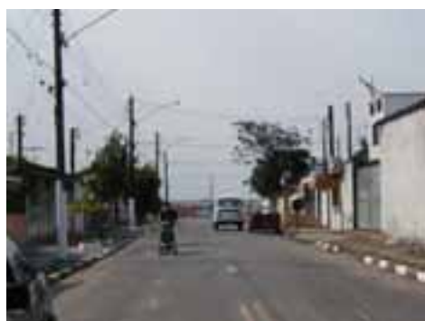
SVI41PON183FOT02 - Viário com microdrenagem insuficiente
