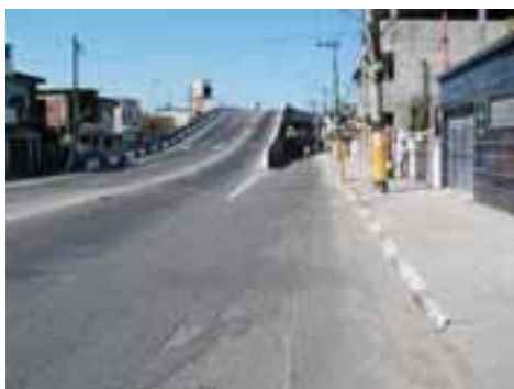
SVI50PON84FOT01 -Viário com microdrenagem insuficiente
