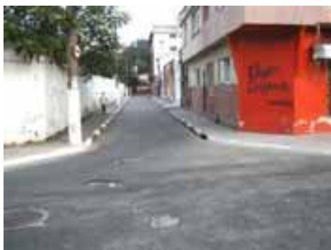
SVI67PON113FOT01 - Viário com microdrenagem insuficiente
