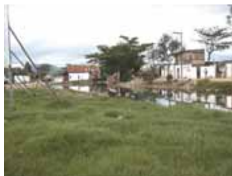
SVI45PON77FOT02 - Canal existente assoreado e obstruído
