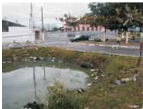
SVI32PON68FOT03 - Canal existente assoreado
