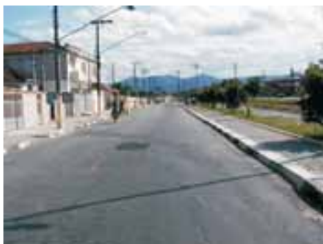
SVI52PON89FOT02 - Viário com microdrenagem insuficiente
