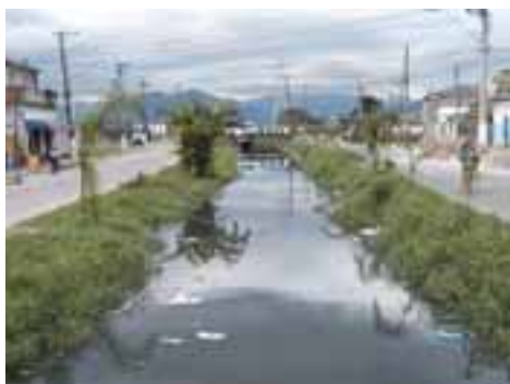
SVI49PON83FOT01 - Canal existente sem proteção e assoreado
