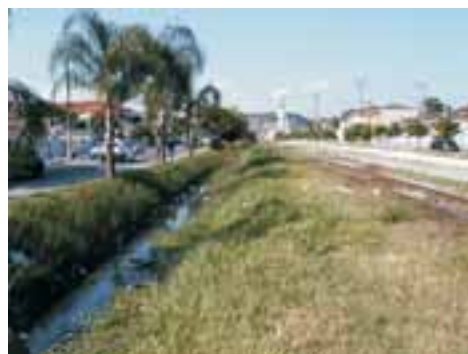
SVI52PON89FOT03 - Canal lateral ao viário obstruído e assorreado
