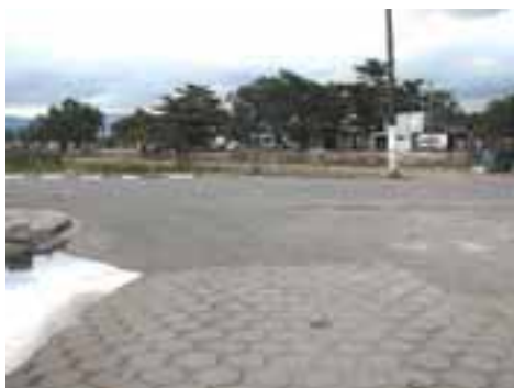
SVI48PON81FOT02 - Viário com microdrenagem insuficiente e afetado pela maré
