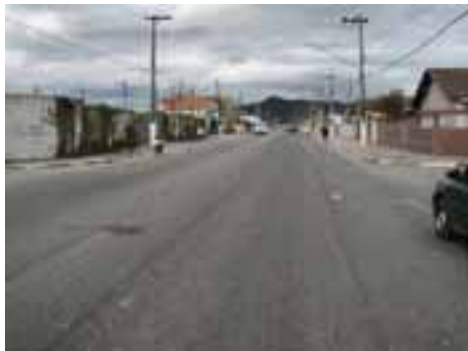
SVI40PON73FOT01 - Viário com microdrenagem insuficiente
