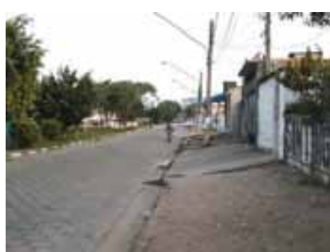
SVI70PON118FOT02 - Viário com microdrenagem insuficiente
