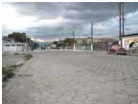
SVI43PON75FOT01 - Viário com microdrenagem insuficiente
