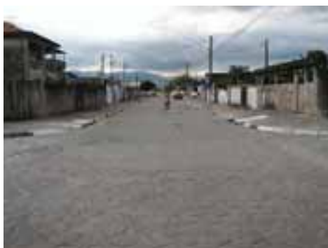
SVI46PON79FOT01 - Viário com microdrenagem insuficiente e afetado pela maré
