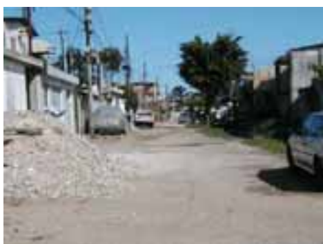
SVI51PON86FOT04 - Viário com microdrenagem insuficiente
