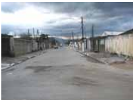
SVI47PON80FOT04 - Viário com microdrenagem insuficiente
