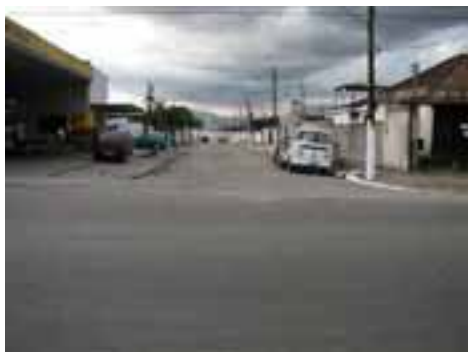
SVI42PON74FOT01 - Viário com microdrenagem insuficiente
