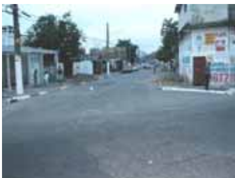
SVI57PON96FOT02 -Viário de microdrenagem insuficiente
