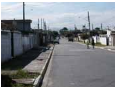
SVI31PON55FOT01 - Viário com microdrenagem assoreada e obstruída
