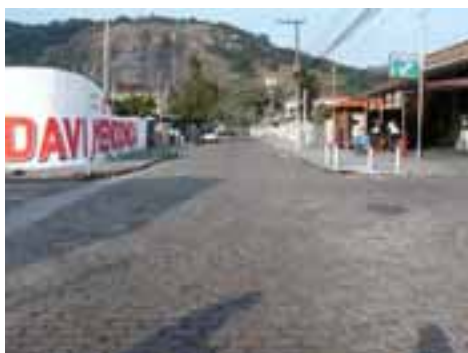
SVI75PON127FOT01 - Viário com microdrenagem insuficiente
