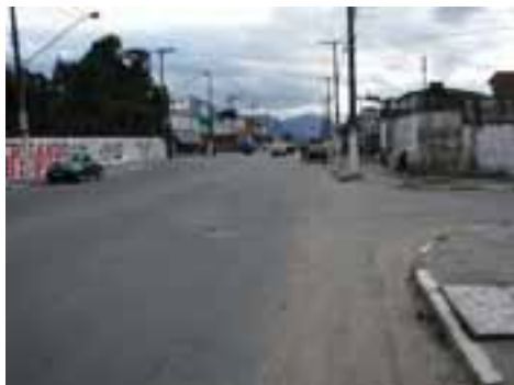
SVI40PON73FOT02 - Viário com microdrenagem insuficiente
