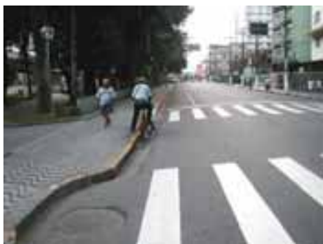
SVI68PON114FOT01 - Viário com microdrenagem insuficiente
