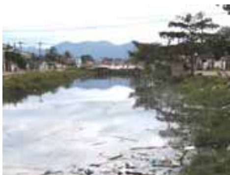
SVI44PON76FOT02 - Canal existente assoreado e obstruído
