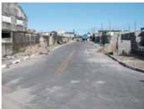
SVI38PON71FOT01 - Viário com microdrenagem insuficiente
