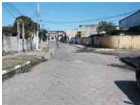
SVI54PON92FOT01 - Viário com microdrenagem insuficiente
