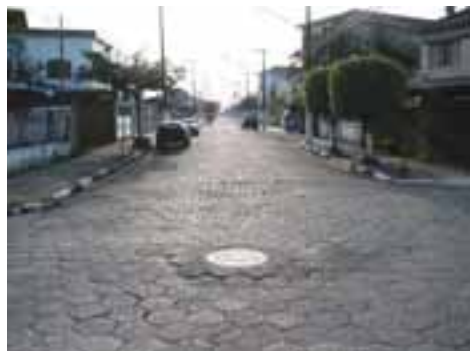
SVI73PON124FOT02 - Viário com microdrenagem assoreada e obstruída
