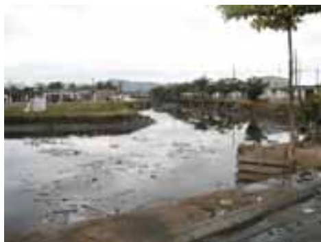
SVI36PON66FOT01 - Canal existente obstruído e assoreado
