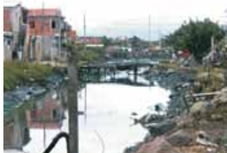
SVI33PON59FOT02 - Detritos e assoreamento no canal existente
