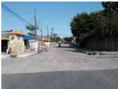
SVI38PON70FOT02 - Viário com microdrenagem insuficiente
