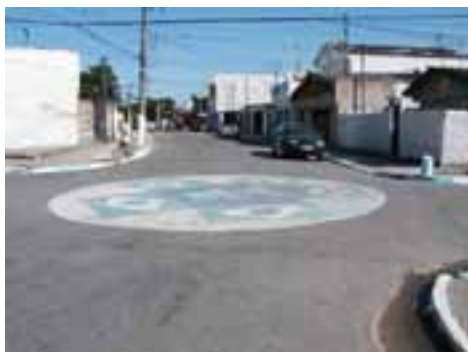
SVI53PON90FOT02 - Viário com microdrenagem insuficiente
