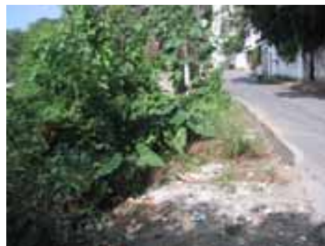
SVI81PON148FOT01 - Encosta apresentando deslizamentos colocando em risco trecho da Av. Saturnino de Brito
