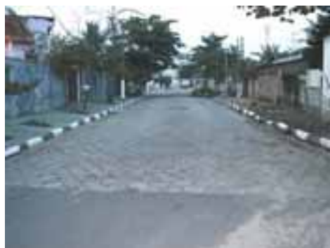
SVI58PON97FOT01 - Viário de microdrenagem insuficiente
