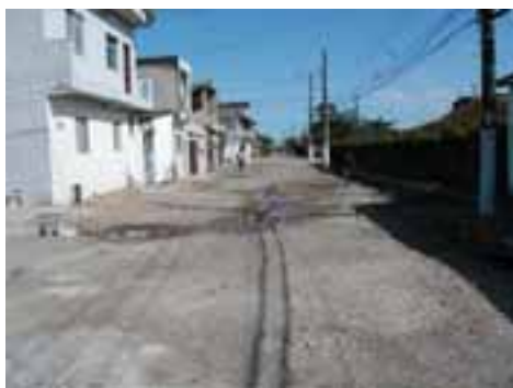
SVI51PON86FOT02 - Viário com microdrenagem insuficiente
