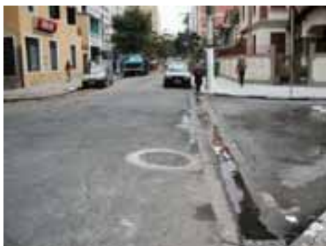
SVI74PON125FOT02 -Viário com microdrenagem insuficiente
