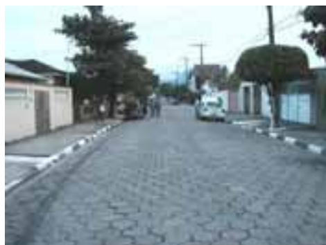
SVI58PON97FOT01 - Viário de microdrenagem insuficiente
