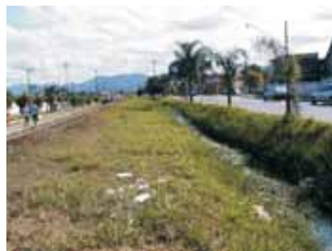
SVI52PON89FOT04 - Canal lateral ao viário obstruído e assorreado
