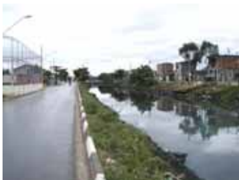
SVI35PON69FOT02 - Canal existente obstruído e assoreado
