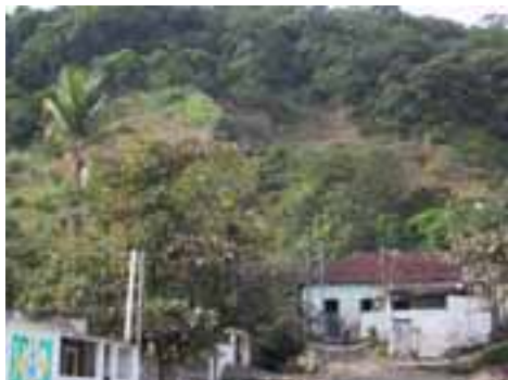
SVI82PON153FOT01 - Morro com áreas de erosão/deslizamento na encosta, colocando em risco habitações localizadas no pé do morro.
