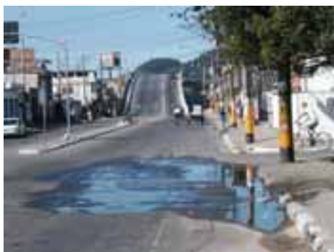
SVI50PON84FOT01 -Viário com microdrenagem insuficiente
