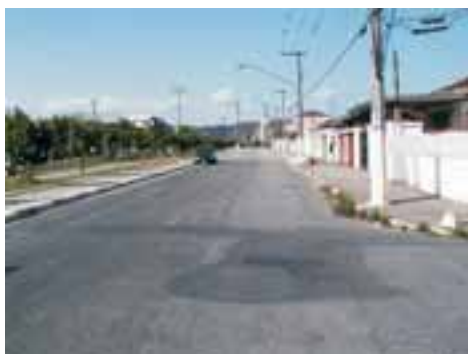
SVI52PON89FOT01 - Viário com microdrenagem insuficiente
