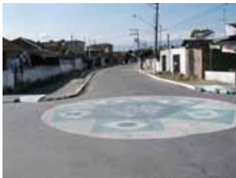
SVI53PON90FOT01 - Viário com microdrenagem insuficiente
