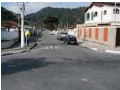
SVI78PON133FOT02 - Viário com microdrenagem insuficiente
