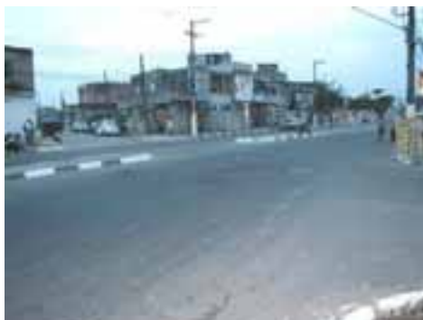
SVI57PON96FOT01 -Viário de microdrenagem insuficiente
