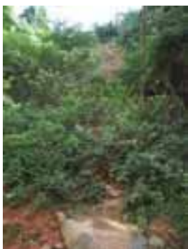
SVI80PON138FOT01 - Vista da encosta onde houve o deslizamento da rua em 1999.
