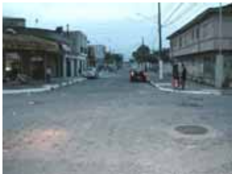
SVI56PON95FOT02 - Viário de microdrenagem insuficiente
