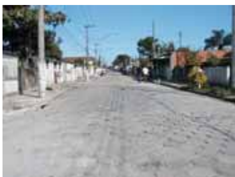
SVI34PON64FOT01 - Viário com microdrenagem insuficiente
