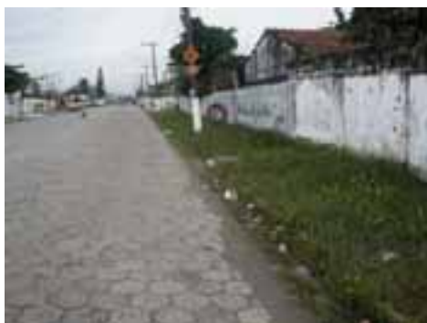
SVI39PON72FOT02 - Viário com micro drenagem insuficiente
