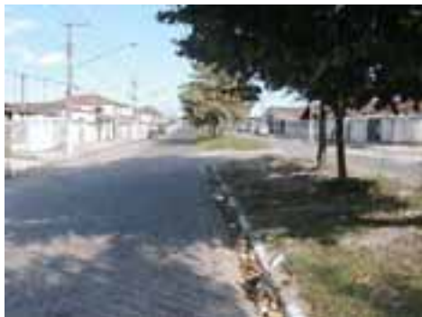
SVI27PON50FOT02 - Viário com microdrenagem assoreada e obstruída
