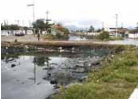
SVI35PON69FOT01 - Canal existente obstruído e assoreado
