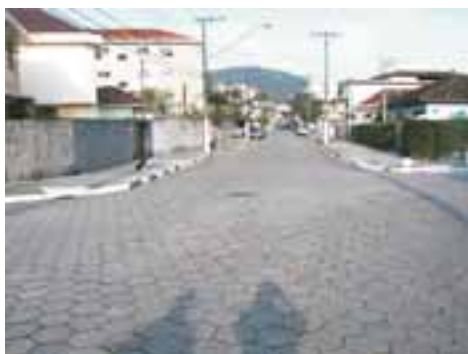
SVI72PON123FOT01 - Viário com microdrenagem assoreada e obstruída
