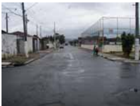
SVI37PON69FOT01 - Viário com microdrenagem insuficiente
