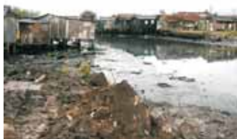
SVI33PON60FOT02 - Detritos e assoreamento no canal existente
