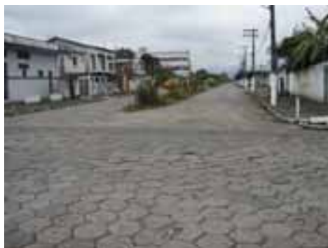
SVI39PON72FOT01 - Viário com micro drenagem insuficiente
