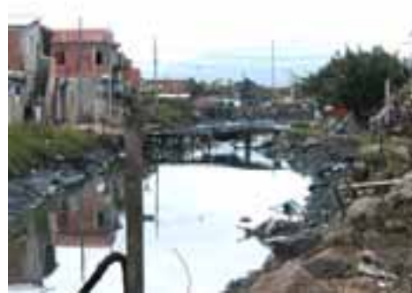
SVI33PON59FOT02 - Detritos e assoreamento no canal existente
