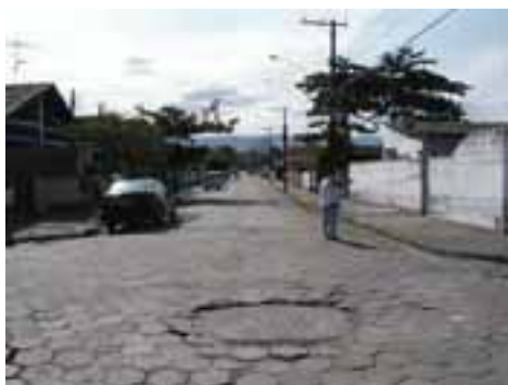
SVI34PON63FOT01 - Viário com microdrenagem insuficiente
