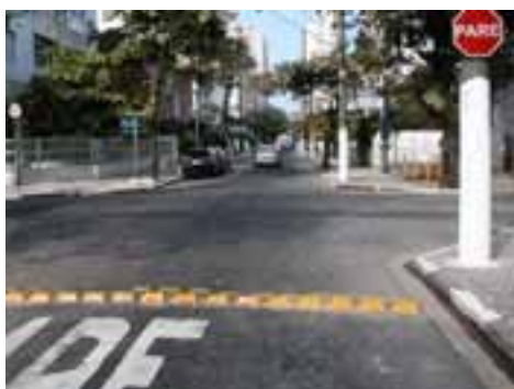
SVI79PON137FOT03 - Viário com microdrenagem insuficiente
