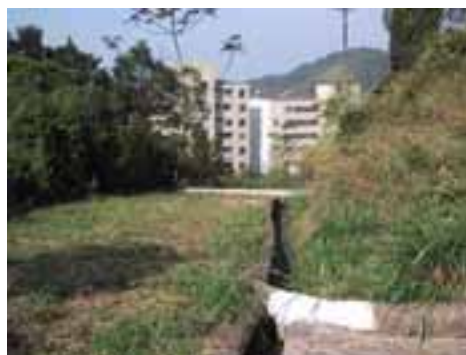
SVI80PON139FOT01 - Vista de rua interrompida por deslizamento de sua pista ocorrido em 1999. Observar canaletas de água pluvial no local.
