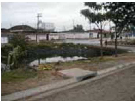
SVI37PON69FOT02 - Lançamento da microdrenagem obstruída
