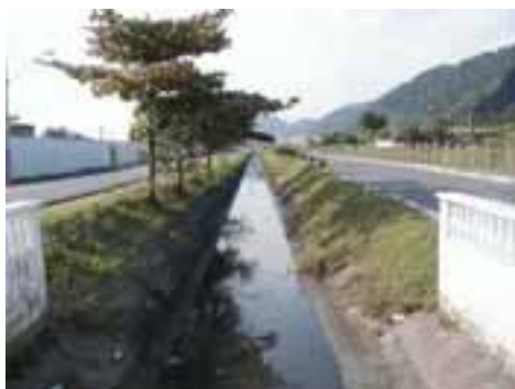
SVI76PON131FOT01 - Canal existente assorreado
