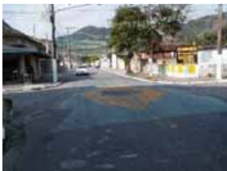
SVI78PON135FOT01 - Viário com microdrenagem insuficiente
