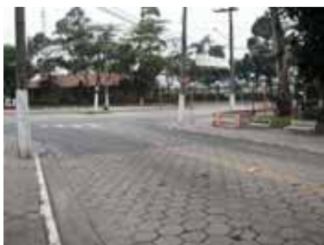
CUB08PON16FOT02 - Bairro com microdrenagem insuficiente e lançamento afetado pela maré
