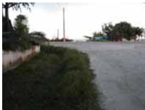
BER20PON36FOT01 - Viário com microdrenagem inexistente e confinado pela rodovia
