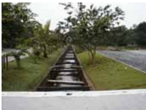
BER13PON24FOT02 - Canal existente assoreado
