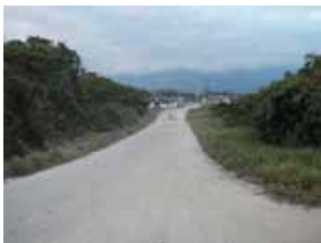
BER18PON34FOT01 - Viário com microdrenagem inexistente e confinado pela rodovia
