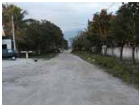
BER20PON36FOT02 - Viário com microdrenagem inexistente e confinado pela rodovia
