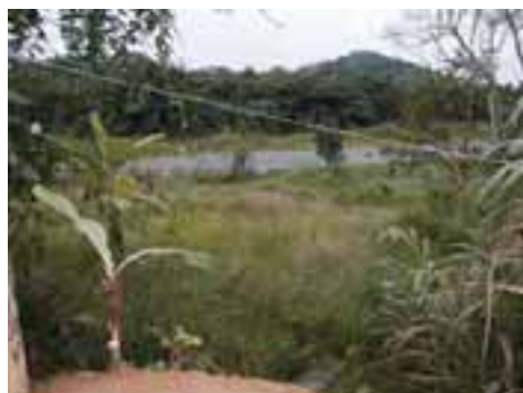
BER17PON32FOT06 - Vista da pista da Rod. Manoel Hyppólito do Rego onde se encontra um bueiro assoreado com material carreado de área com erosão / deslizamento
