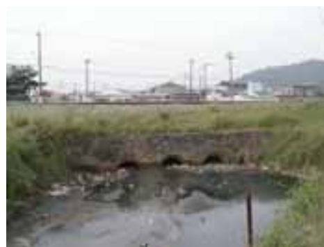
CUB04PON10FOT02 - Travessia existente obstruída
