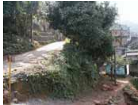
CUB12PON24FOT04 - Detalhe do deslizamento de talude sobre e sob a via principal da ocupação.
