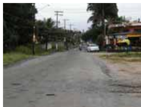
BER11PON20FOT02 - Viário com microdrenagem inexistente
