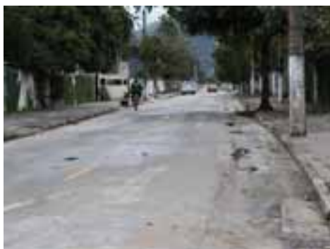
BER02PON05FOT02 - Microdrenagem existente obstruída e assoreada
