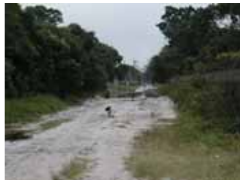
BER15PON27FOT01 - Viário com microdrenagem inexistente
