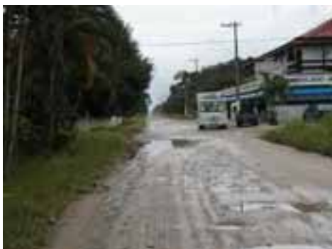
BER11PON21FOT02 - Viário com microdrenagem inexistente
