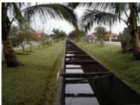
BER13PON23FOT02 - Canal existente assoreado
