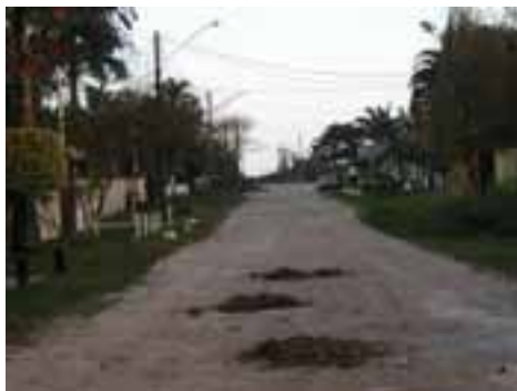
BER19PON35FOT01 - Viário com microdrenagem inexistente e confinado pela rodovia
