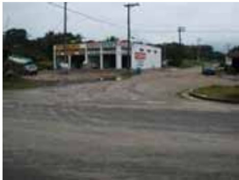
BER09PON14FOT02 - Viário com microdrenagem insuficiente
