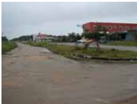
BER09PON15FOT01 - Viário com microdrenagem insuficiente
