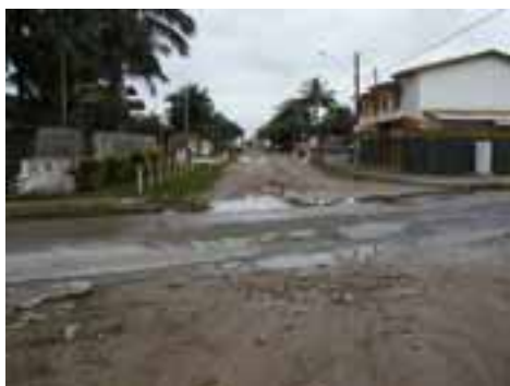
BER08PON13FOT01 - Viário com microdrenagem insuficiente
