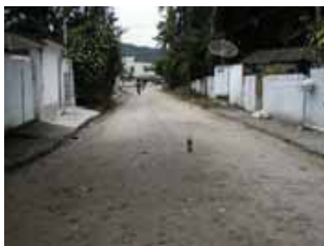
BER01PON01FOT01 - Inexistência de microdrenagem
