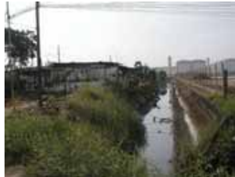
CUB04PON08FOT01 - Canalização existente obstruída
