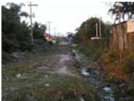
BER19PON35FOT02 - Viário com microdrenagem inexistente e confinado pela rodovia
