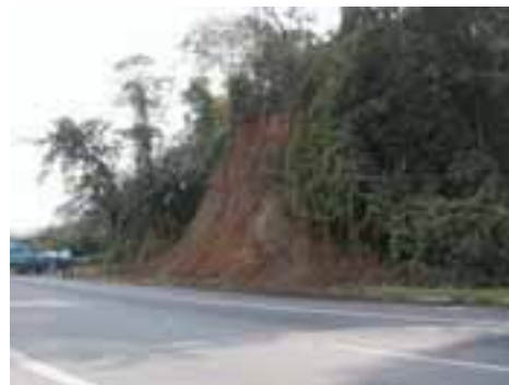
CUB17PON43FOT02 - Detalhe de talude com risco de deslizamento sobre a pista da Piaçaguera-Guarujá.
