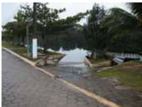
BER14PON26FOT03 - Lançamento afetado pelo nível d'água do rio
