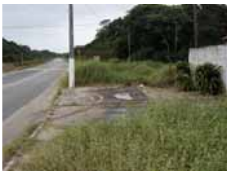
BER10PON16FOT03 - Viário com microdrenagem insuficiente
