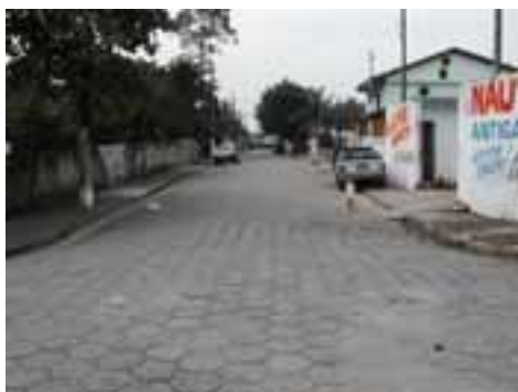
CUB06PON12FOT01 - Bairro com microdrenagem assoreada e obstruída
