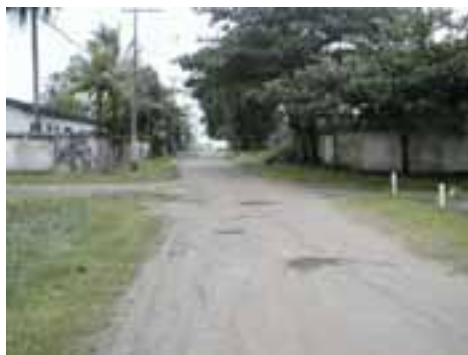
BER05PON09FOT01 - Inexistência de microdrenagem
