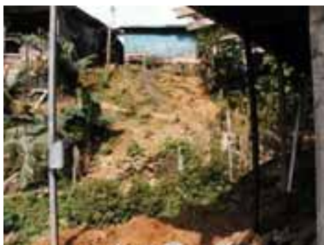
CUB14PON29FOT02 - Detalhe das condições do solo nas áreas de encosta ocupadas.
