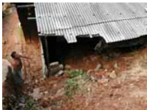
CUB16PON38FOT02 - Detalhe de talude deslizado sobre barraco.
