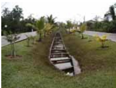
BER14PON26FOT01 - Canal existente assoreado
