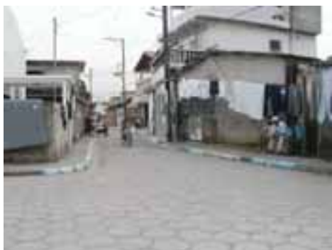
CUB07PON13FOT01 - Viário com microdrenagem insuficiente
