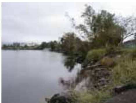
BER16PON31FOT01 - Erosão da margem (Terreno da Prefeitura) causada pelo Rio Itapanhá.
