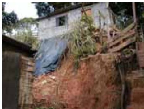
CUB16PON38FOT01 - Detalhe de barracos localizados no topo e pé do talude com risco de deslizamento.
