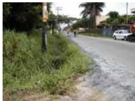
BER11PON18FOT02 - Viário com microdrenagem inexistente
