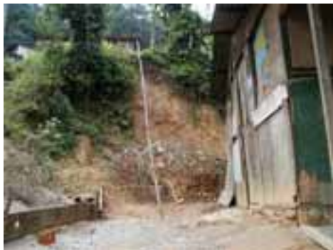
CUB15PON33FOT01 - Detalhe de barraco junto a talude de corte com risco de deslizamento.
