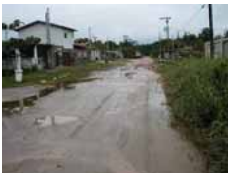
BER12PON22FOT03 - Viário com microdrenagem inexistente
