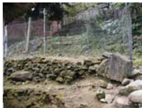
CUB10PON20FOT01 - Arrimo de pedra em condições precárias de estabilidade
