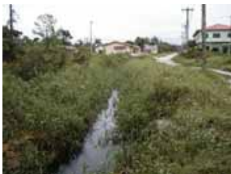
BER15PON28FOT01 - Canal existente assoreado
