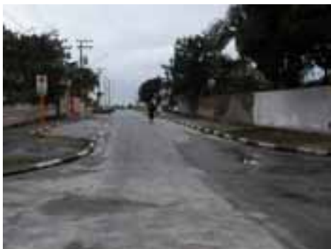
BER02PON04FOT02 - Microrenagem existente obstruída e assoreada
