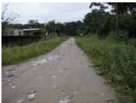
BER12PON21FOT03 - Viário com microdrenagem inexistente
